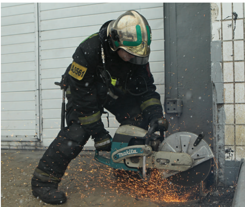
Перед дежурством стоит проверить оборудование
