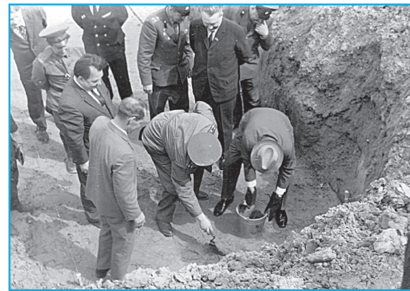
В.М. Бибанин смонтировала первую фундаментную подушку. Строительство первого жилого дома и будущего города началось!
