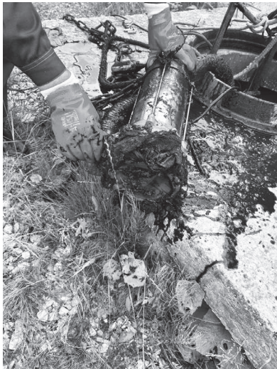
Забитая канализационная труба.
